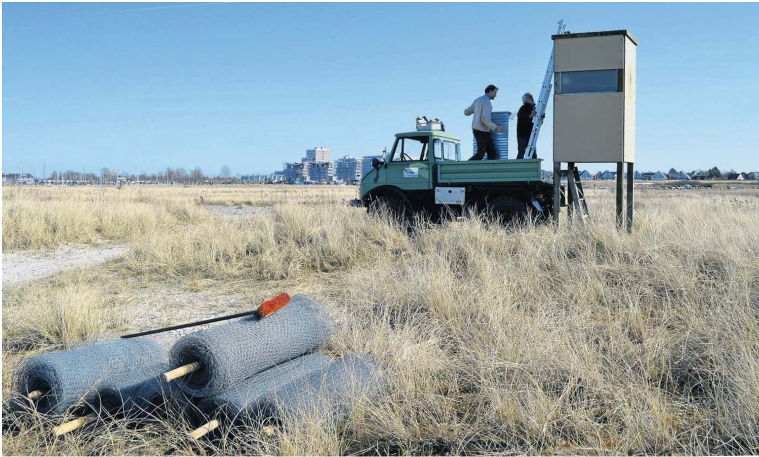
Carsten Harrje (links) und Wilfried Knief montieren eine Haube für den Beobachtungsturm. Im Vordergrund liegt bereits der Draht für den Schutzzaun. FOTO: THOMAS CHRISTIANSEN
